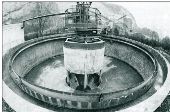
Abb. 89: Entschlammungsanlage für Feinstsand-Rückgewinnung aus dem Waschwasser
