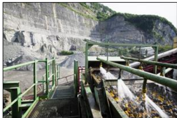
Abb. 124: Waschanlage der Recyclingstation
