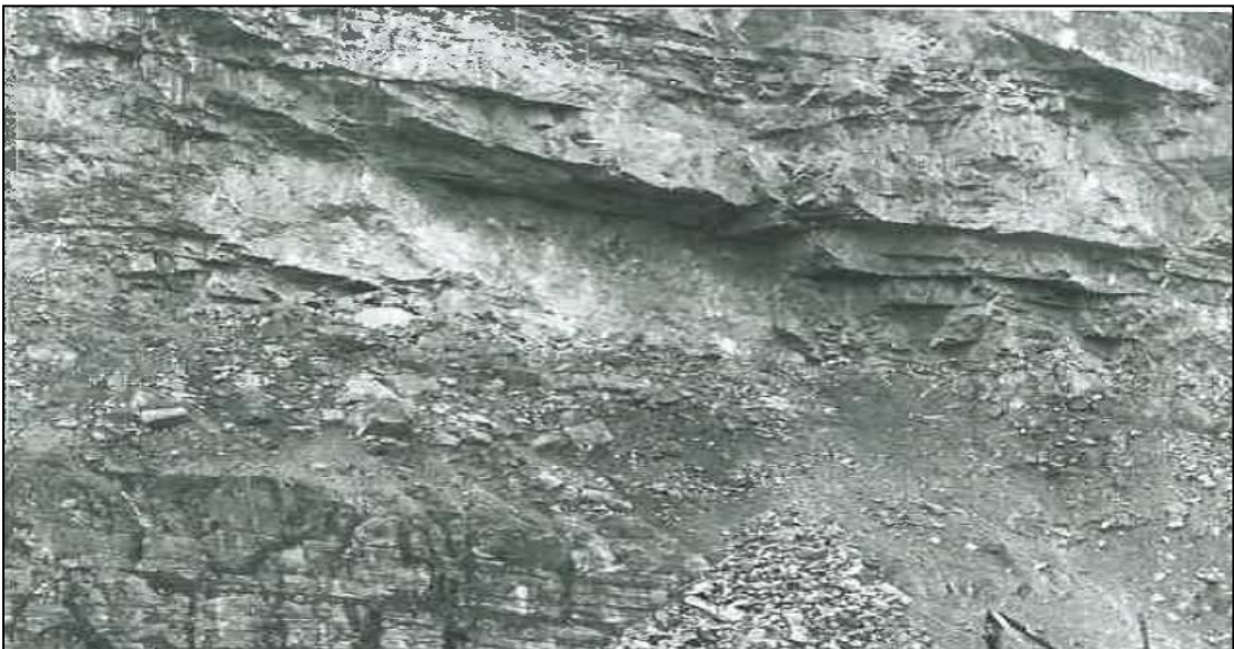
Abb. 70: Einer der zahlreichen Überhänge im Steinbruch Unterklien vor der Sanierung der Felswand. Diese gefährlichen Überhänge wurden nach der Übernahme des Steinbruchs durch die Fa. W. Rhomberg mittels Sicherheitssprengungen und den geordneten industriemäßigen Etagenabbau beseitigt.
